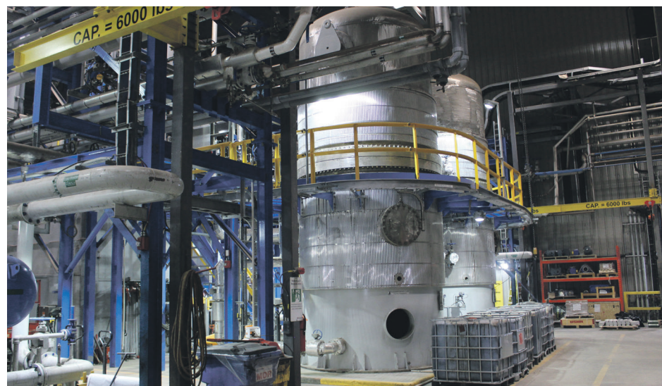
L'intérieur de l'usine de Bioénergie Æ Côte-Nord.
